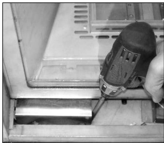
Module de contrôle de l'évent installé dans le foyer .
